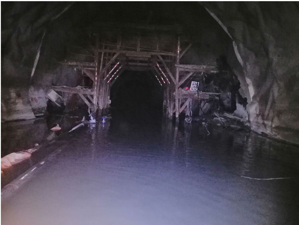
图 C.3 新场隧道洞内积水与排水条件
